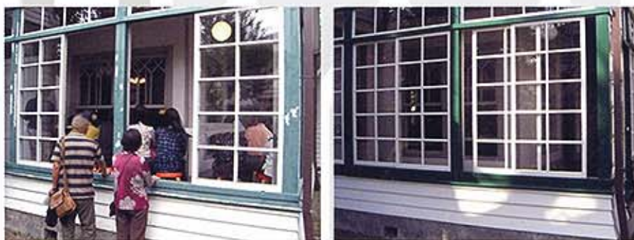
庭から見学する人も。右側は修繕後の同じ壁面です。修繕前と後のちがいがわかりますね。
