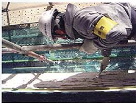
「けれん」作業風景。これは2階外壁のけれん作業です。足場から離れ、横倒しになって宙を浮いた状態での作業です。外壁の剥離は、手作業で行われました。
