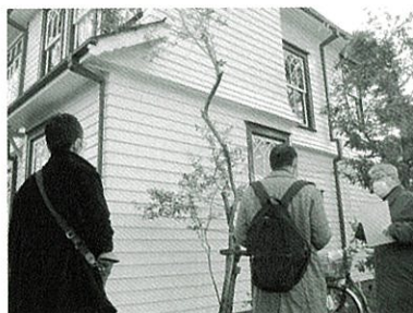
▲湿気により損傷しやすい北側外壁
