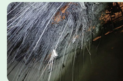
焼却炉内部に絡まった不燃物
