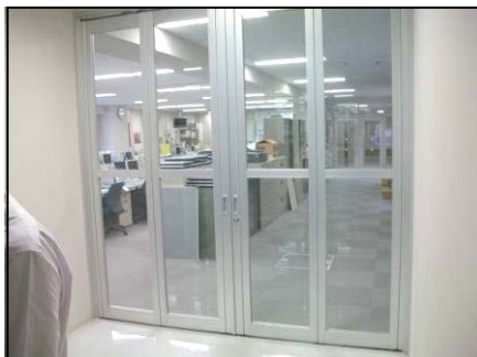
職員の連携に配慮し、隣接して配置され、小・中の職員が行き来が可能になっている職員室。
