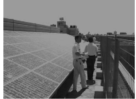
屋上の太陽光パネル
