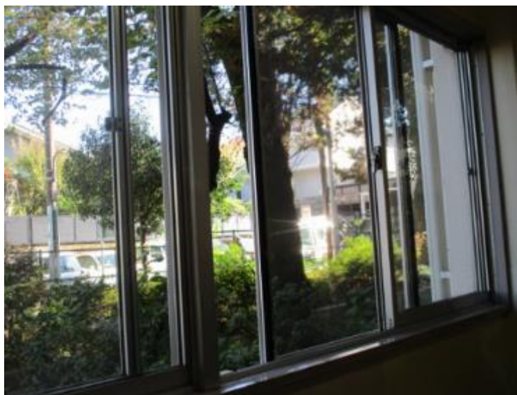
(さくら小学校 1階廊下に網戸が設置されている。)
