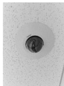
(区庁舎内防犯カメラ)
