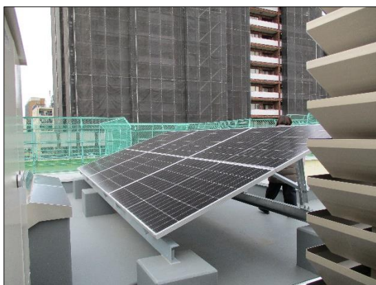
▲ 太陽光パネル（屋上）
