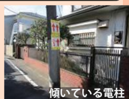
傾いている電柱
