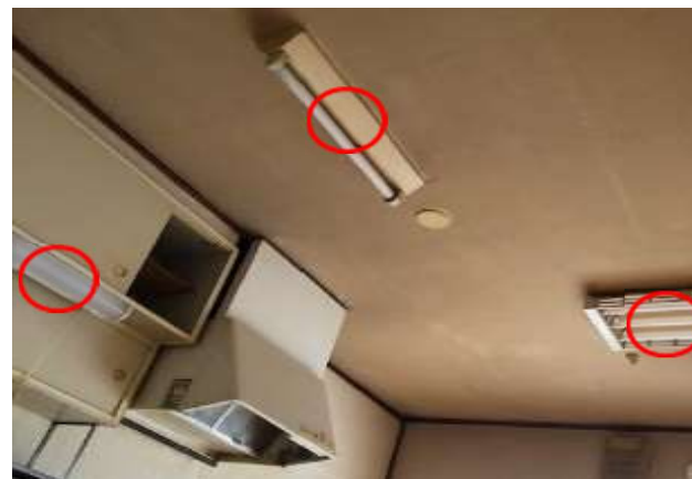
住戸内照明器具の例
