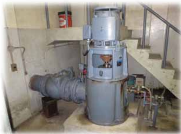
◆ビックリガード排水ポンプ
